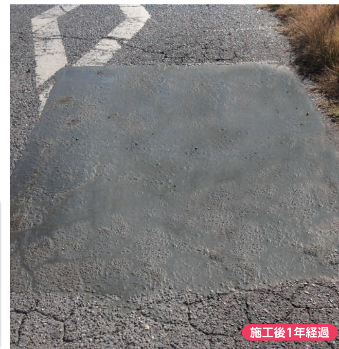
拡大写真 (濃い色はクラック充填部)
