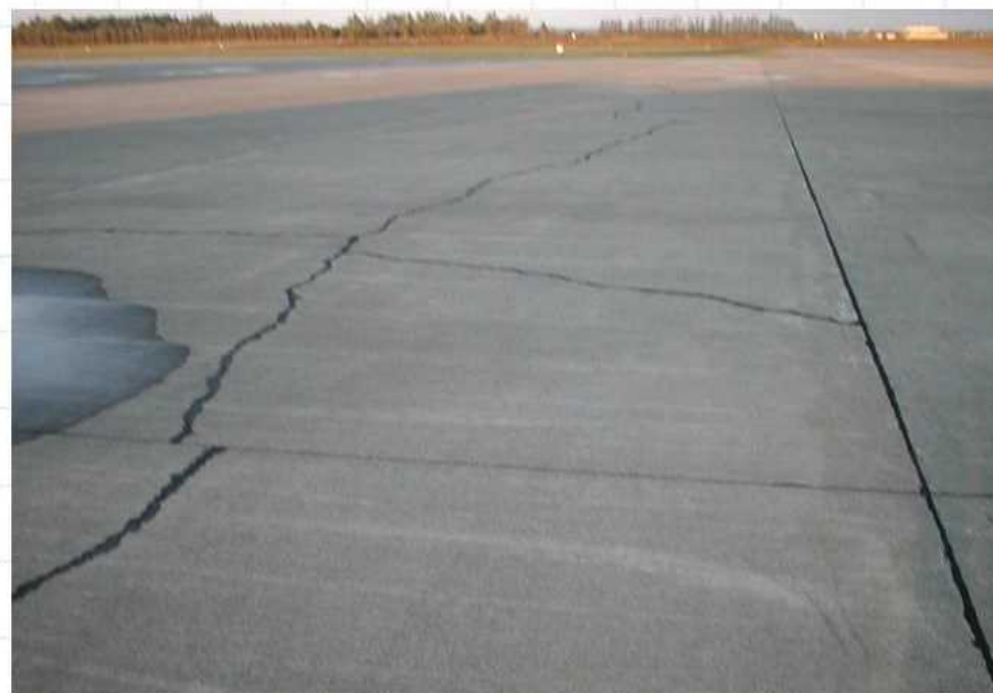
凍上によるひび割れ
